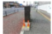
電線共同溝の地上機等を歩道と自転車道の間に設置した事例
