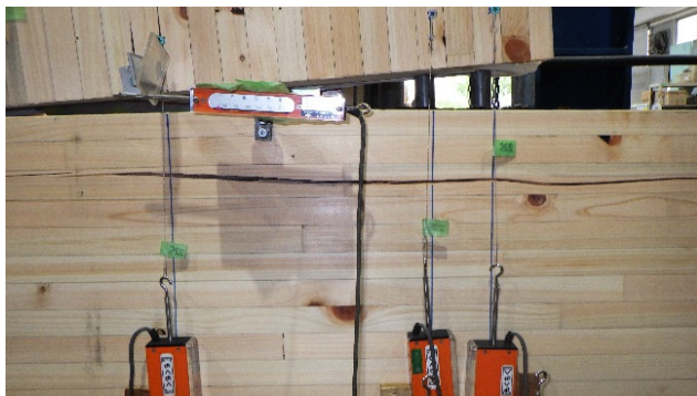
パネルゾーン割裂破壊
