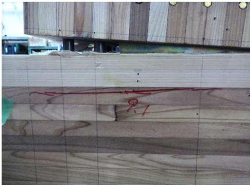
ビスの位置でのひび割れ
