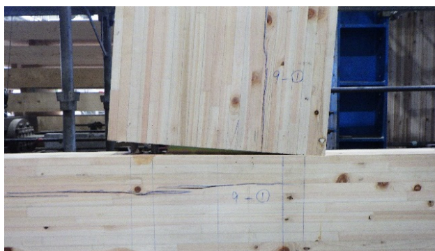
ビスの位置でのひび割れ
