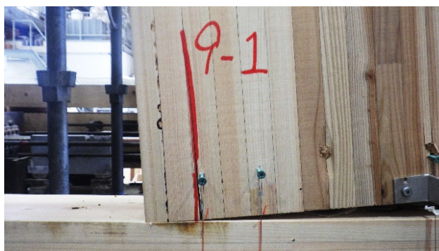
コネクタ位置でのひび割れ
