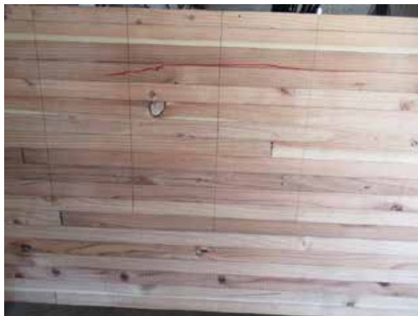
写真 2 柱部材におけるせん断受け金物の取り付け ビス位置からの横引張割れ（S2-750-01）
