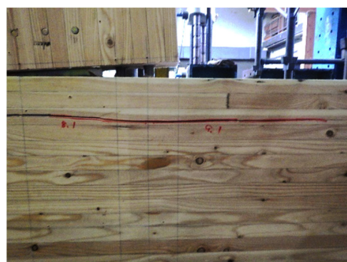
ビスの位置でのひび割れ
