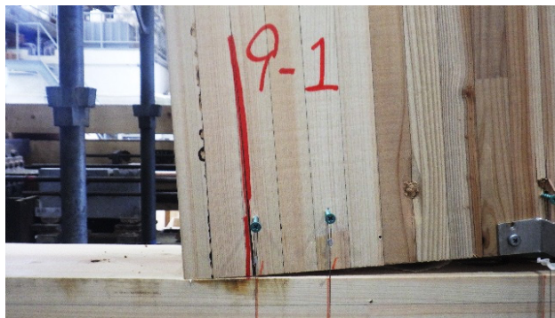
コネクタ位置でのひび割れ
