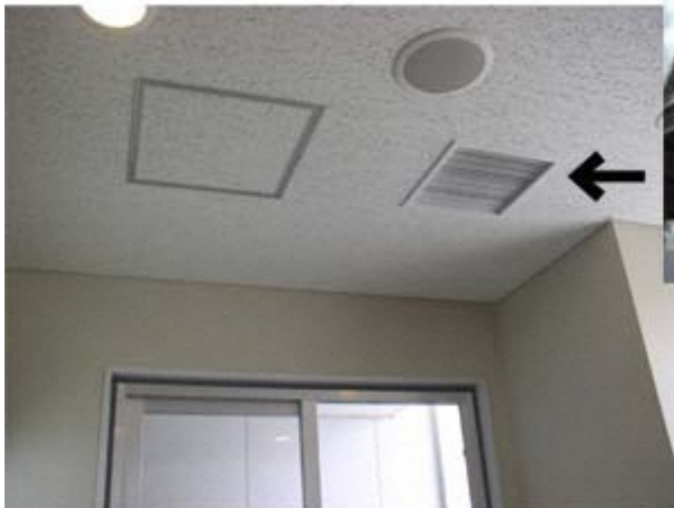
天井に排気口
