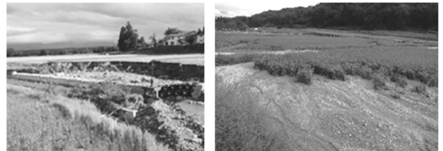
写真5 萩生川沿いで崩落した水田 写真6 土砂堆積の水田
