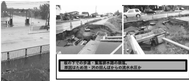
写真 11(左) 椿地区の西丘陵から道路上の流水(滝のごとく) 写真 12(右) 椿地区の道路、沢、水田からの流水で破壊
