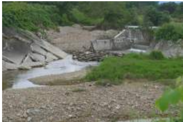
図 23 萩生川と八幡堀の合流点の護岸崩落
