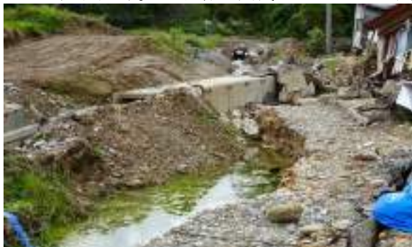
写真 19. 河床の荒廃 (10月8日 15:50頃)
