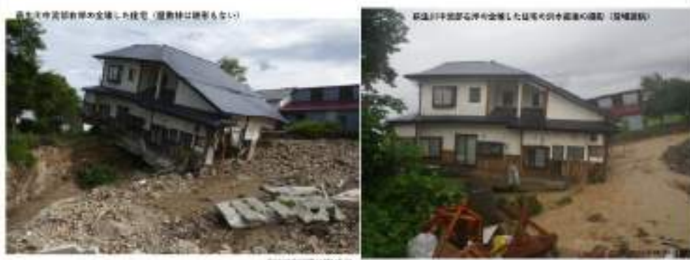
図6 萩生川の洪水により屋敷林と住宅が全壊した（二反田橋の横）
