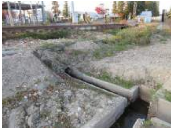
図 25 樺の踏切近くの水路と破壊された線路
