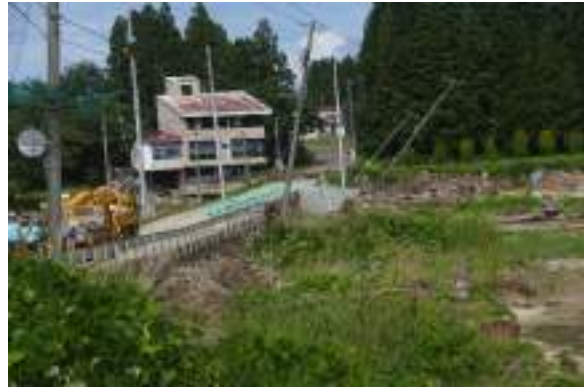
図 33 大巻橋の崩落と横の農地の被害
