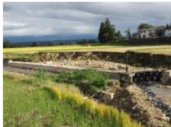
図10 萩生川中流右岸の圃場崩落
