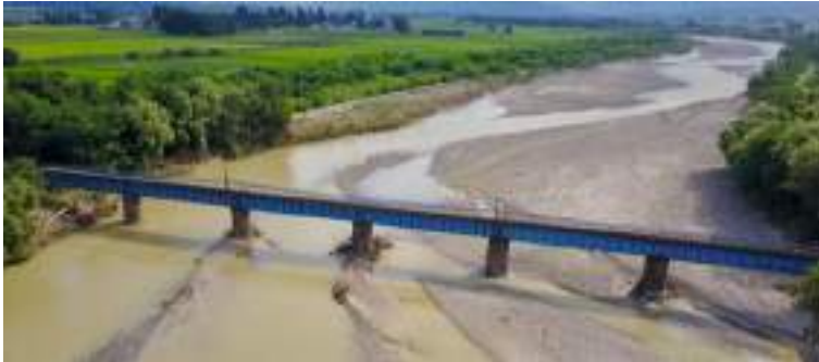
写真 41. 山形鉄道白川鉄橋（8月11日15:20頃空撮）
