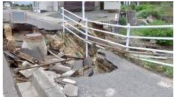
写真 28. 道路の洗掘 (8月4日 16:20 頃)
