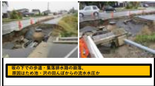
図10 図9の右下の道路の歩道の破壊。集落下水道の配管の破壊
