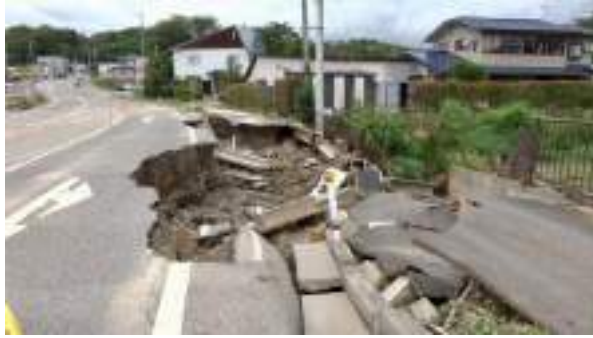
写真 27. 道路の洗掘 (8月4日 16:20 頃)
