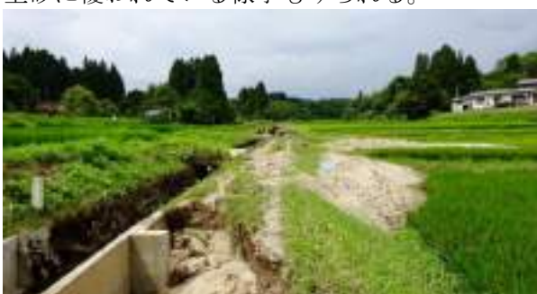
写真 25. 柳沢排水路（8月7日 10:35 頃）
