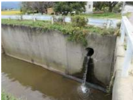
図 23 八幡排水路に流れ込み道路側溝水
