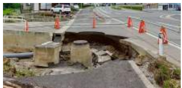
写真 26. 道路の洗掘（8月7日 10:30 頃）
