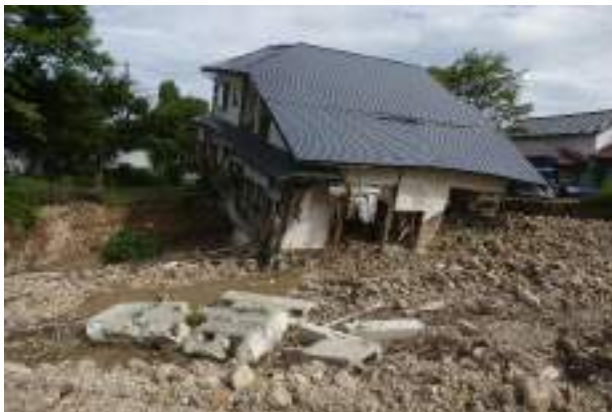
図1 2022年9月2日の緊急調査 萩生川二反田橋沿いの全壊住宅
