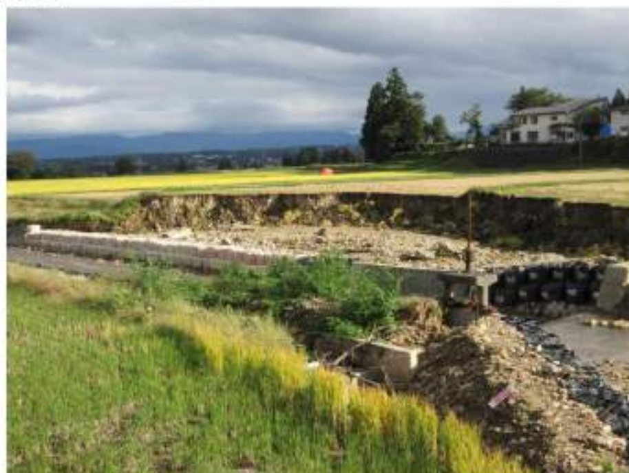
図8 萩生川の氾濫で崩壊した河川沿いの水田
