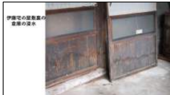
図9 伊藤賢一氏宅の納屋の浸水状況
