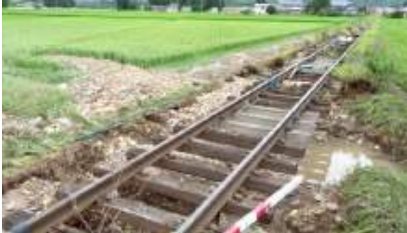
写真 20. 米坂線の敷石の洗掘（8月4日 16:40 頃）
