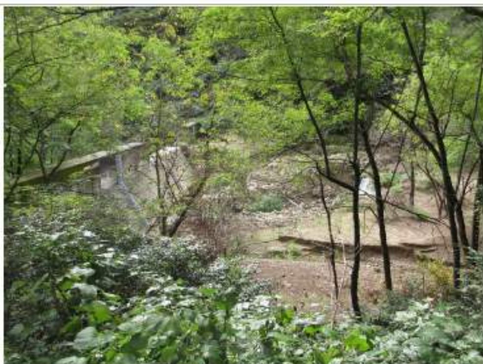
図9 新沼橋上流の砂防堰堤内の土砂と立木（2023年10月撮影）
