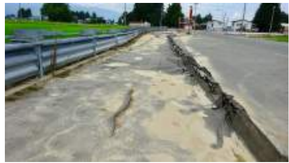
写真 16. 道路の損傷 (8月11日 12:10頃)
