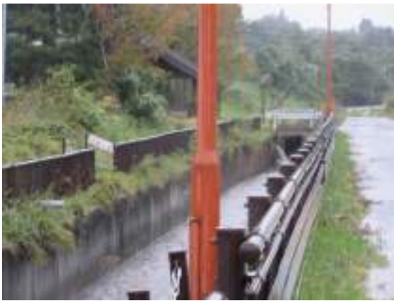
図 21 椿の財津堂の八幡排水路、雨水が流れ込む
