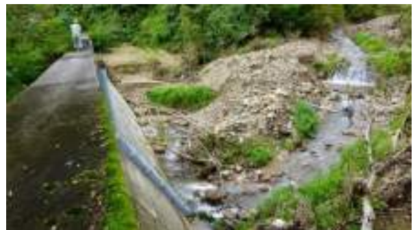
写真 3. スリットダム（10月8日14:00頃）
