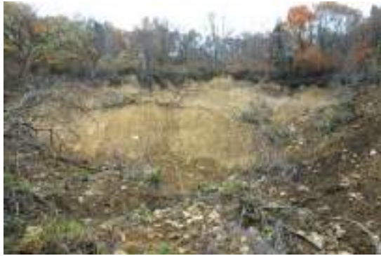
写真1 崩壊箇所の頂部
