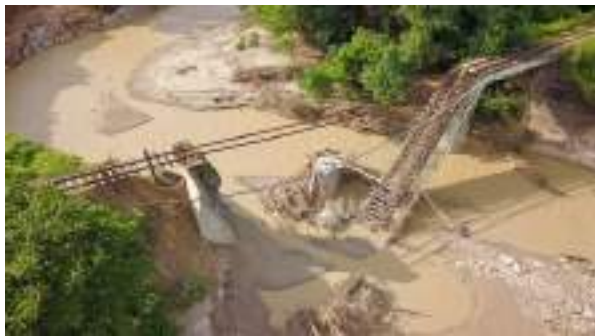
写真 39. 崩落した米坂線鉄橋 (8月7日 16:10 頃空撮)
