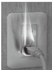
トラッキング現象
